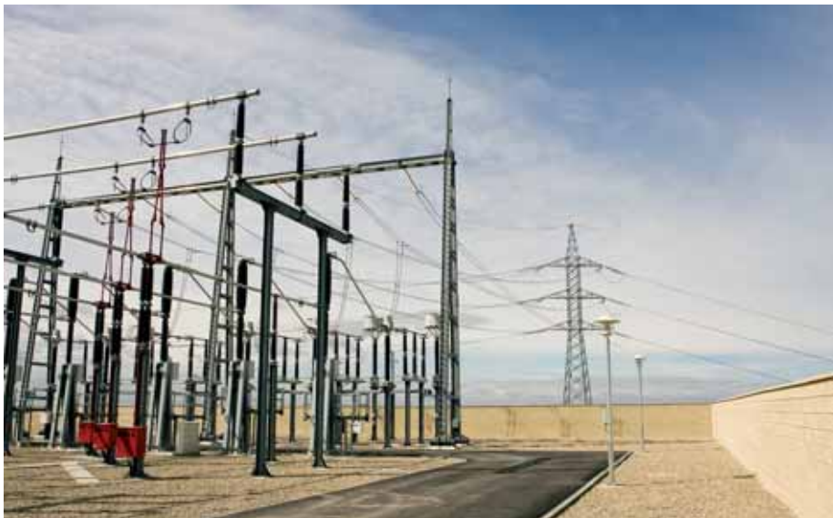
L'energia generada s'envia a la xarxa per mitjà de la línia de la Poble de Segur-Pierola.
